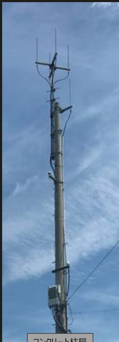
コンクリート柱局
