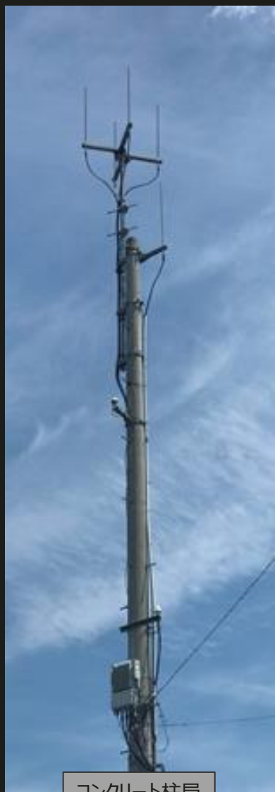
コンクリート柱局
