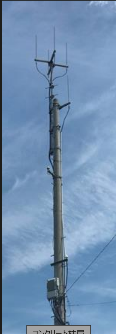
コンクリート柱局
